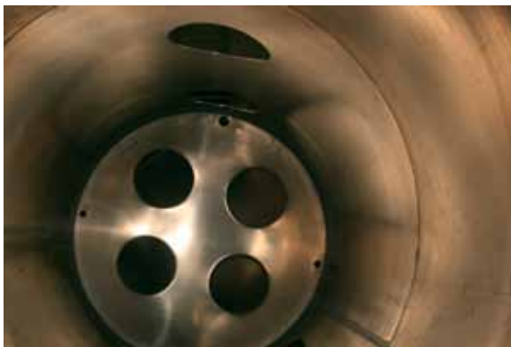
Schwallbleche im Inneren der Tanks
